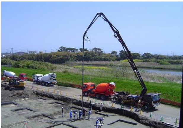
4/16 ミキサー車につながれたこの車が、長いホースのようなものでコンクリートを流し込んでいきます。
