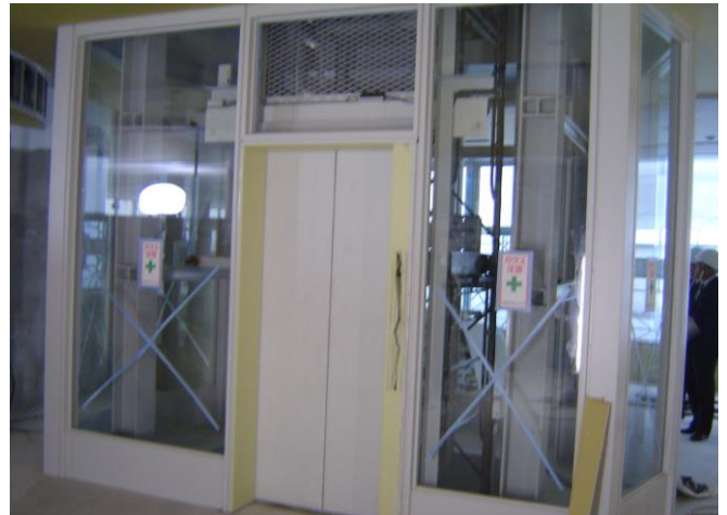
利用者用のエレベーターはガラス張りです。
